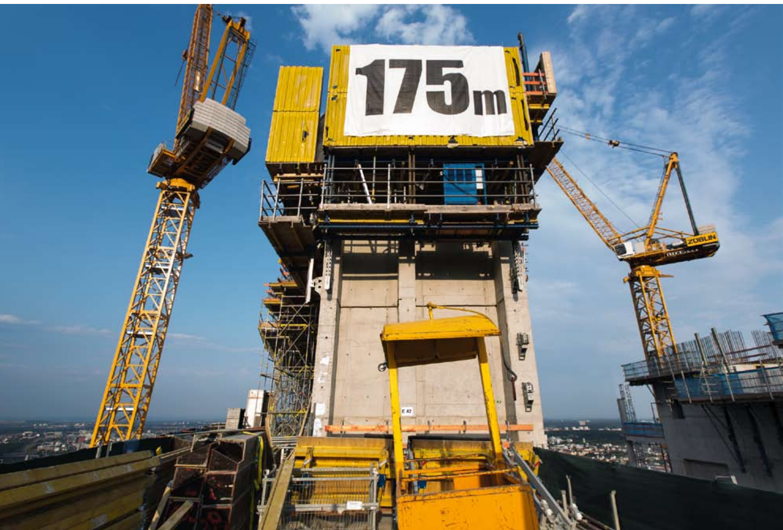
La doppia torre di uffici ha raggiunto l'altezza di 175 m. nel luglio 2012. Sul lato orientale è in fase di montaggio il telaio per le vetrate dell'atrio.
