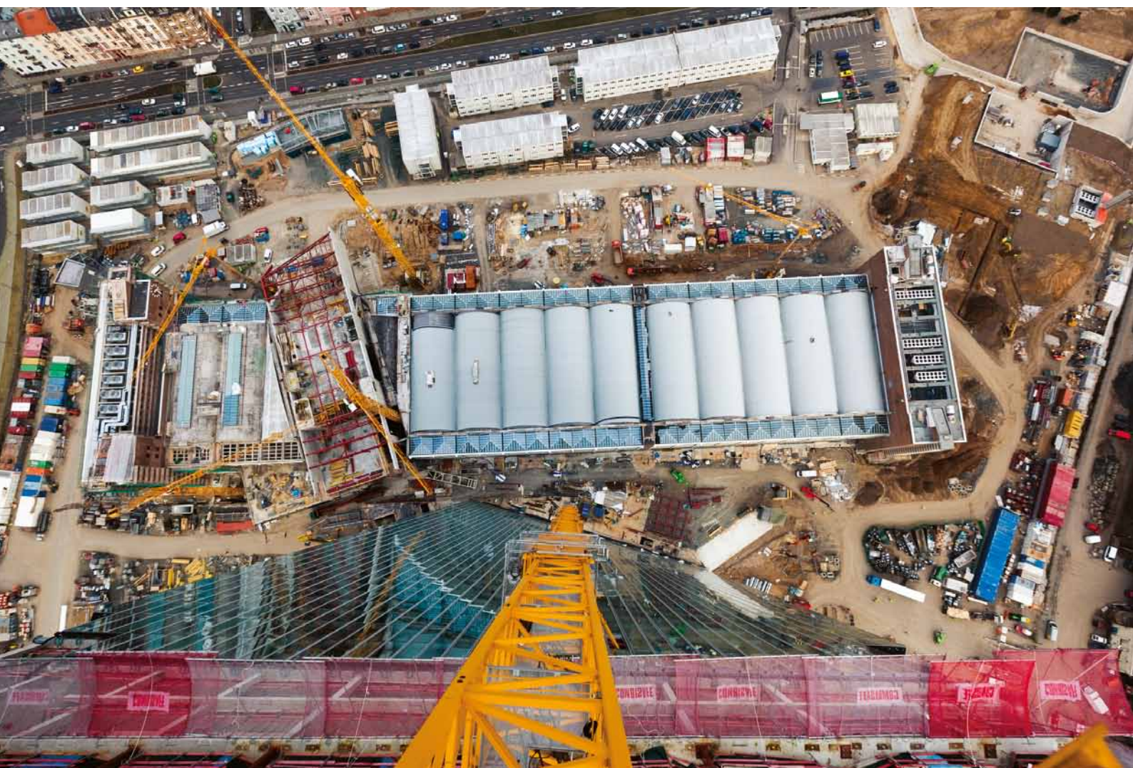
2013. aastal edenes EKP uute hoonete ehitus silmnähtavalt. Ehitise kõigi uute osade konstruktsioonitööd lõpetati kevadel ning Grossmarkthalle katuse betoonkoorikud restaureeriti aasta lõpuks. Avara turuhalli sisemus on samuti renoveeritud.
