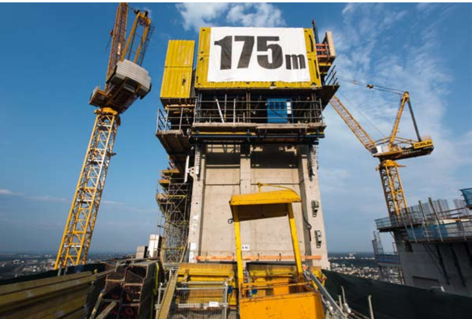
2012 m. liepos mėn. dviejų dalių biurų bokšto aukštis pasiekė 175 m. Aukštybinio pastato rytinėje pusėje statoma konstrukcija atriumui įstiklinti.
